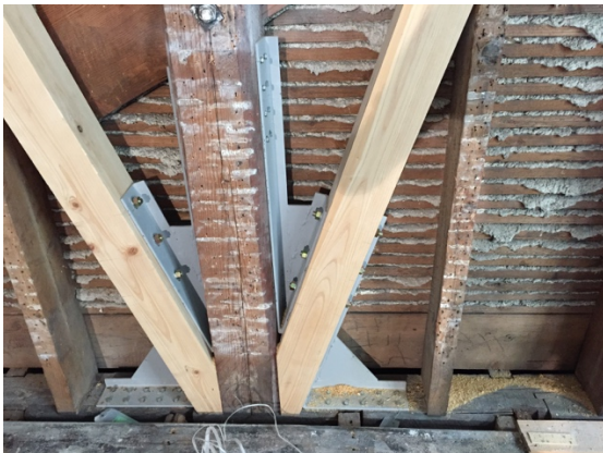
写真4 記念館の耐震改修工事で使われた補強金物
